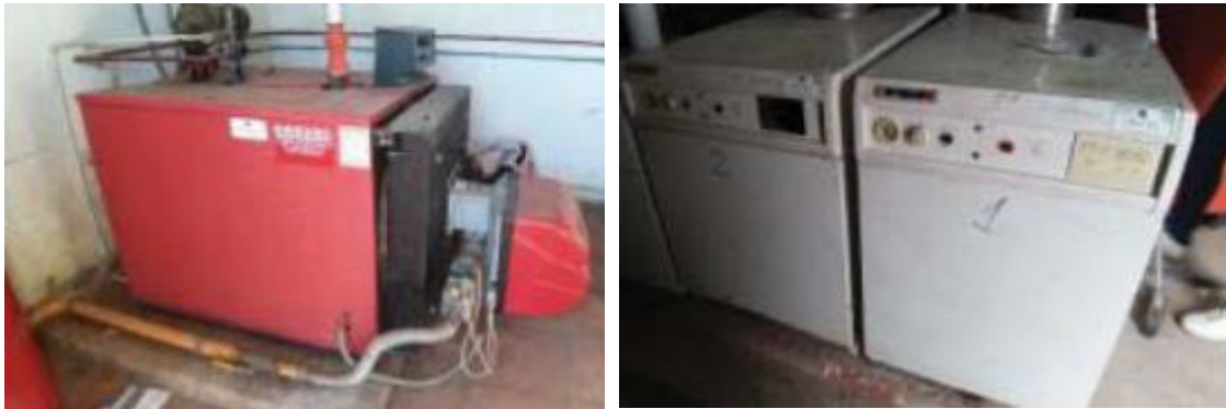
Ilustración 4. Imágenes representativas de la instalación inicial de producción de calor en el polideportivo
