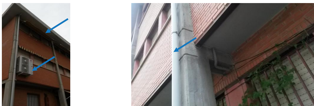
Figura 17: Factores de riesgo debidos a instalaciones en fachada
