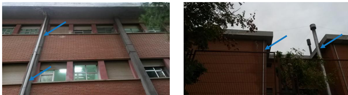
Figura 16: Factores de riesgo debidos a elementos no estructurales
